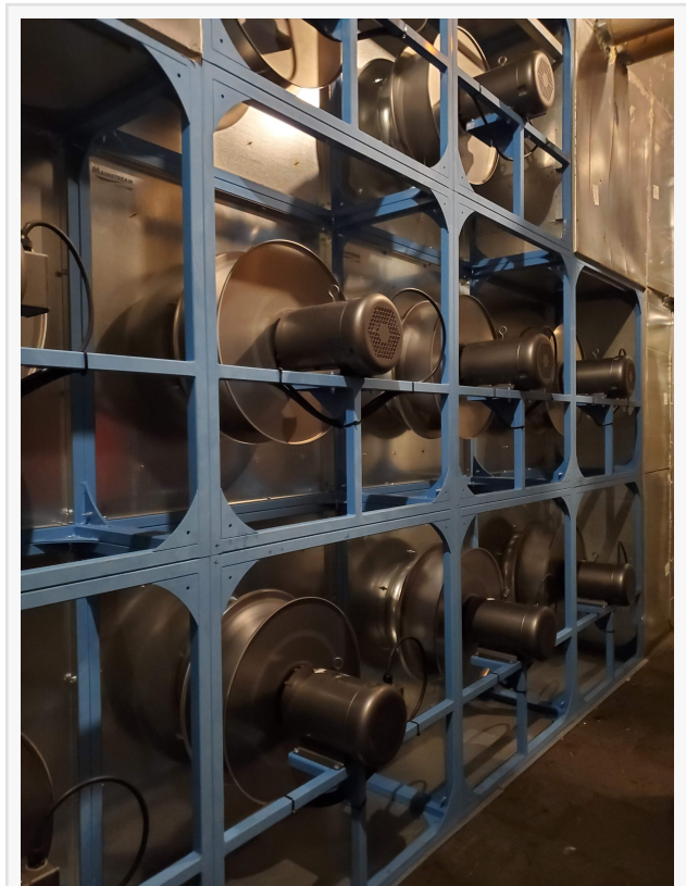
HVAC Fan Array
