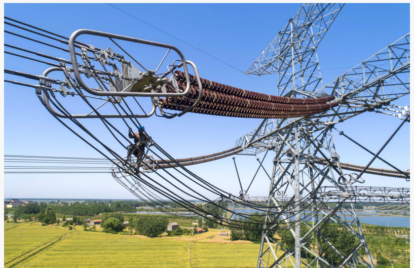
Líneas aéreas eléctricas
