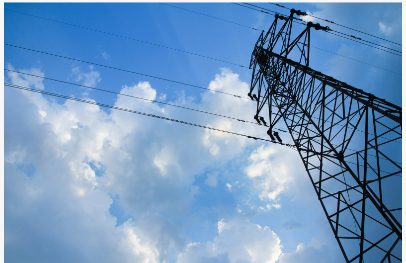
Líneas aéreas para electricidad
