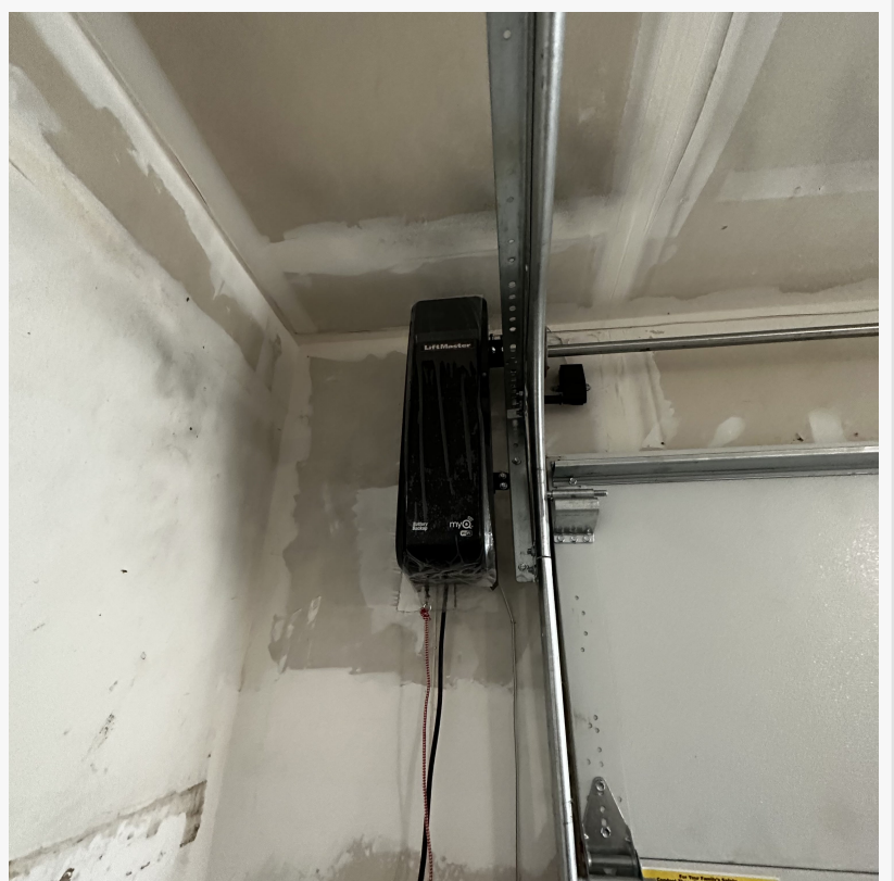
broken garage door
