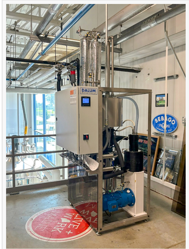
Sebago Brewing Co.'s new DALUM CO2 Recovery Plant
