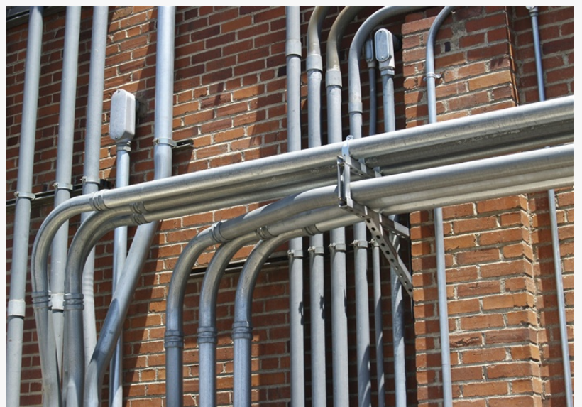
Electrical Conduit Pipe
