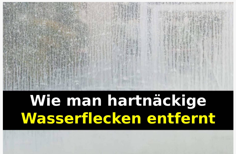
Weißer Belag am Fenster
