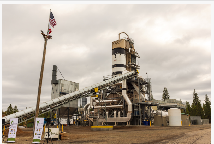
Hat Creek Bioenergy Facility
