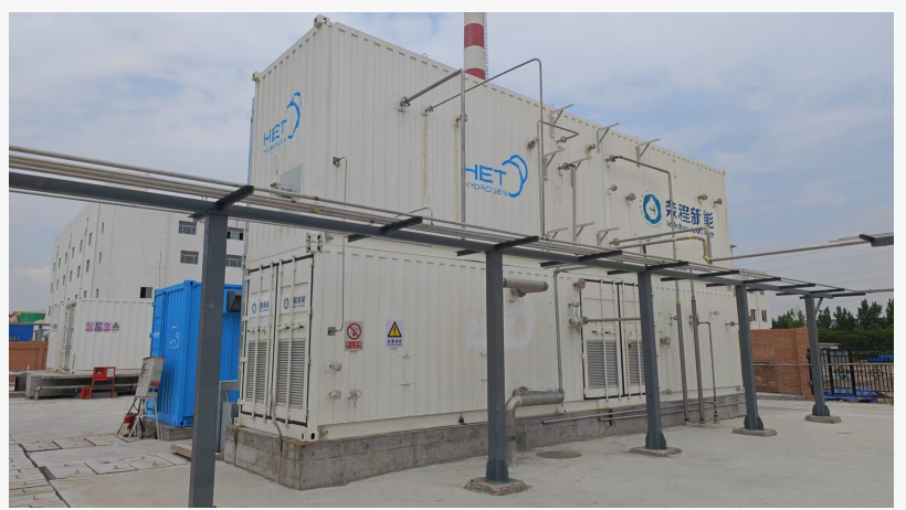
HET 5MW AEM Electrolyser Gas System
